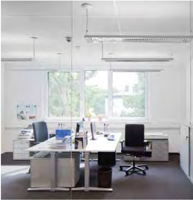
Geschlossene Metaldecke mit Aktivierung durch Graphit im Büroraum
